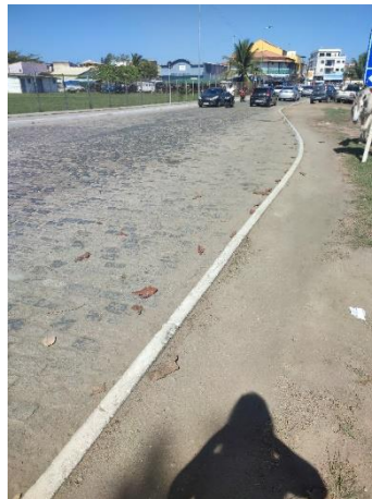
Figura 20 - Trecho sem sinalização vertical (Rua Roberto Silveira)
